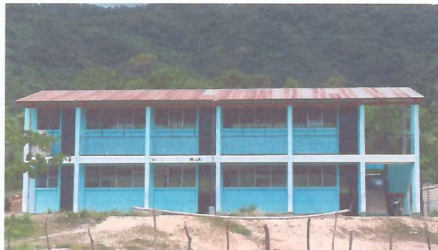
Foto1: MEJORAMIENTO DE TECHO A LAMINA TROQUELADA CALIBRE 26 Y MANTENIMIENTO DE ESTRUCTURA PORTANTE GENERAL
